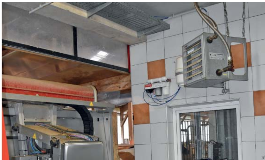
Bild 6: Ein Heizlüfter hält die Melkbox frostfrei.
