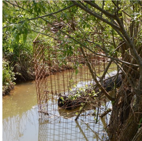
Abbildung 9: Dreiecksförmiger Gitterkorb am Rohreinlauf einer Dammdrainage
