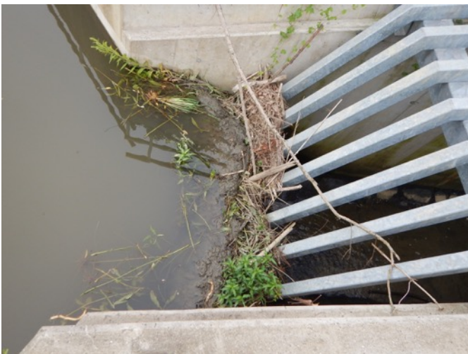
Abbildung 5: Durchlassbauwerk eines Rückhaltebeckens im Südburgenland - verstopfter Rechen
