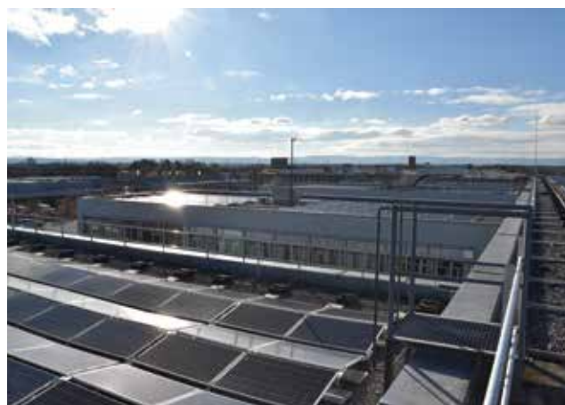
■ PV-Anlage auf dem Dach des TZ Eisenstadt
