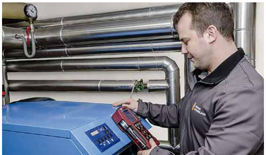
Foto: Energie Burgenland
